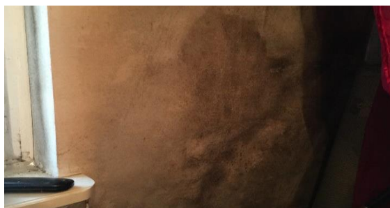
Плесень на наружной стене изнутри
